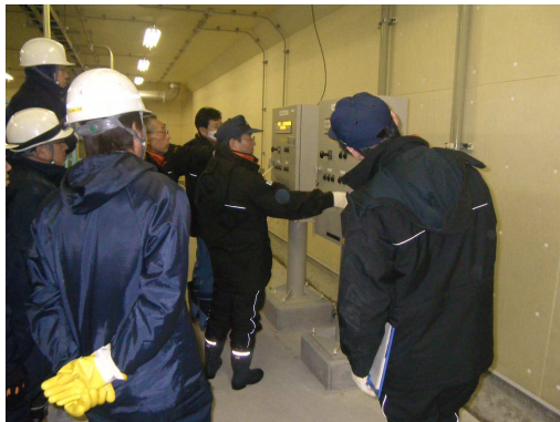
緊急遮断弁の操作確認
