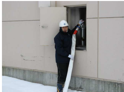
緊急給水口のバルブ操作
